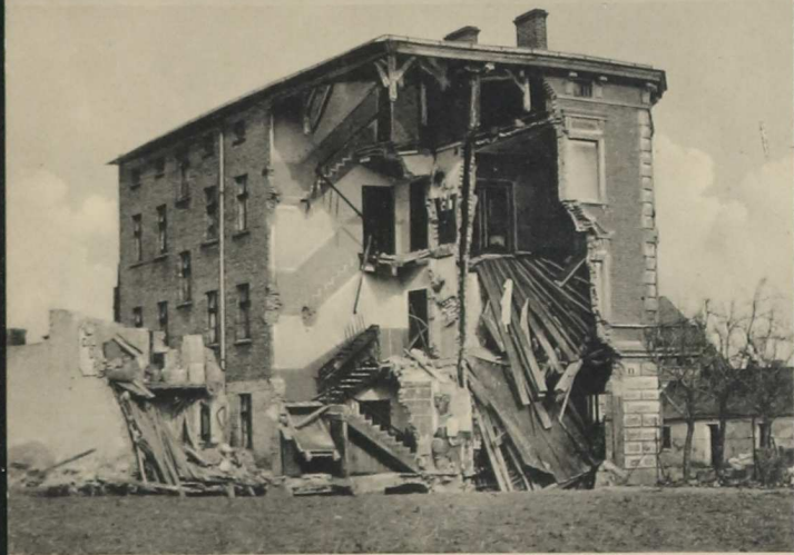
Wohn- u. Geschäftshaus Hohensalza, Orlovoerstr. 12, das infolge einer Erdsenkung am 7. und 8. November 1911 eingestürzt und versunken ist.
